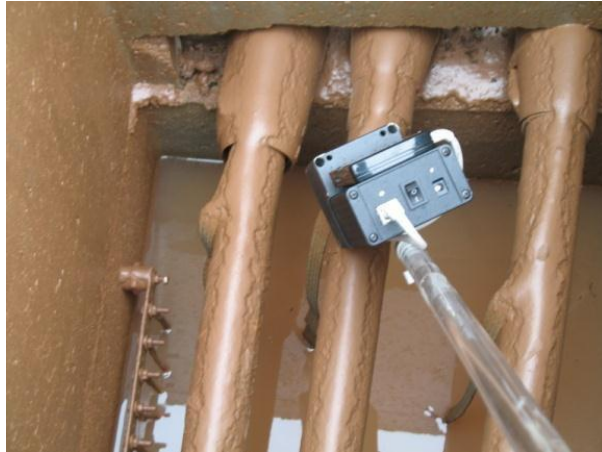
Пример измерения на кабельной муфте (конец муфты).
