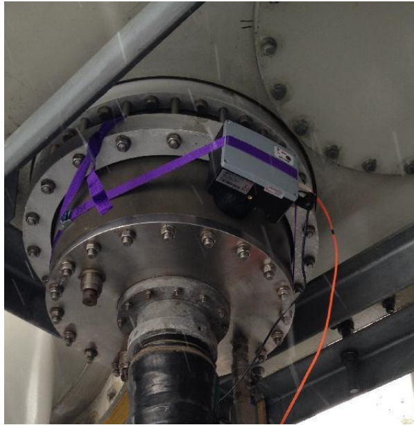
Пример измерения на выводе КРУЭ (изолирующее кольцо).
