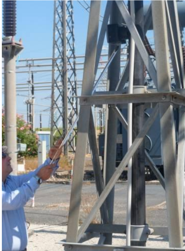
Пример измерения на внешнем выводе (вывод заземляющего кабеля).
