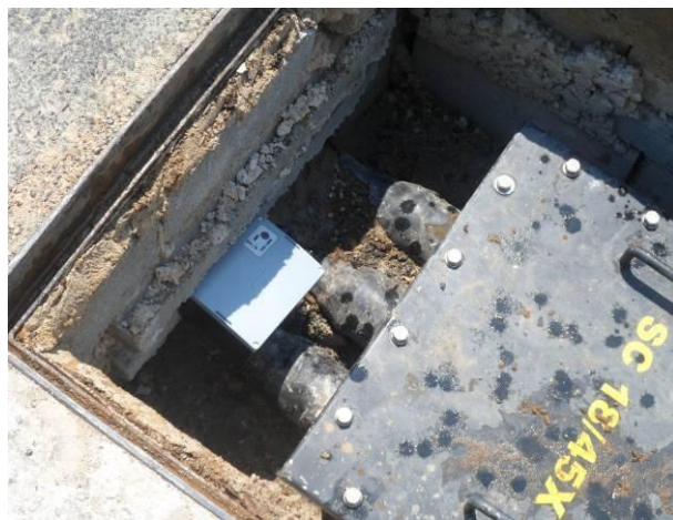
Пример измерения на кабельной муфте (заземление экрана рядом с соединительной коробкой).
