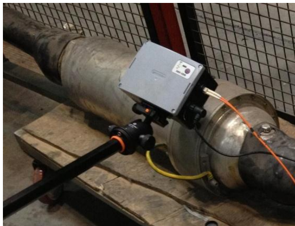
Пример измерения на кабельной муфте (заземление экрана).
