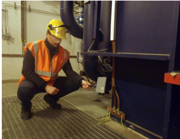
Пример измерения на силовом трансформаторе (заземление трансформатора).
